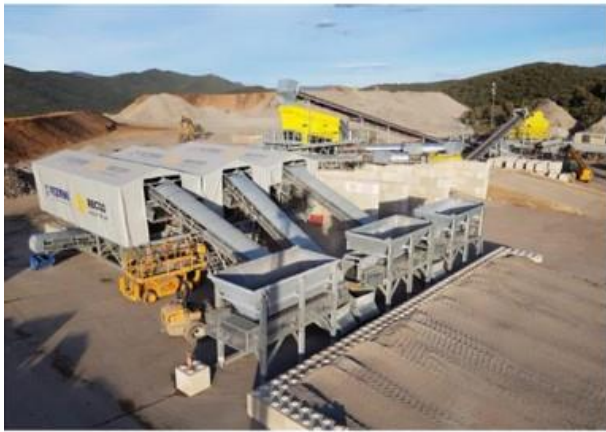
Installation de Maturation et d'Elaboration des mâchefers
